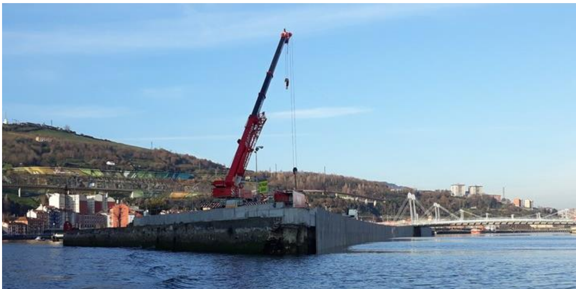
Figura 4.1. Imagen tomada en enero de 2019 del antiguo canal de Deusto, una vez conectado con el cauce de la Ría. En el centro se aprecia la actual isla de Zorrotzaurre y a la derecha el canal.
